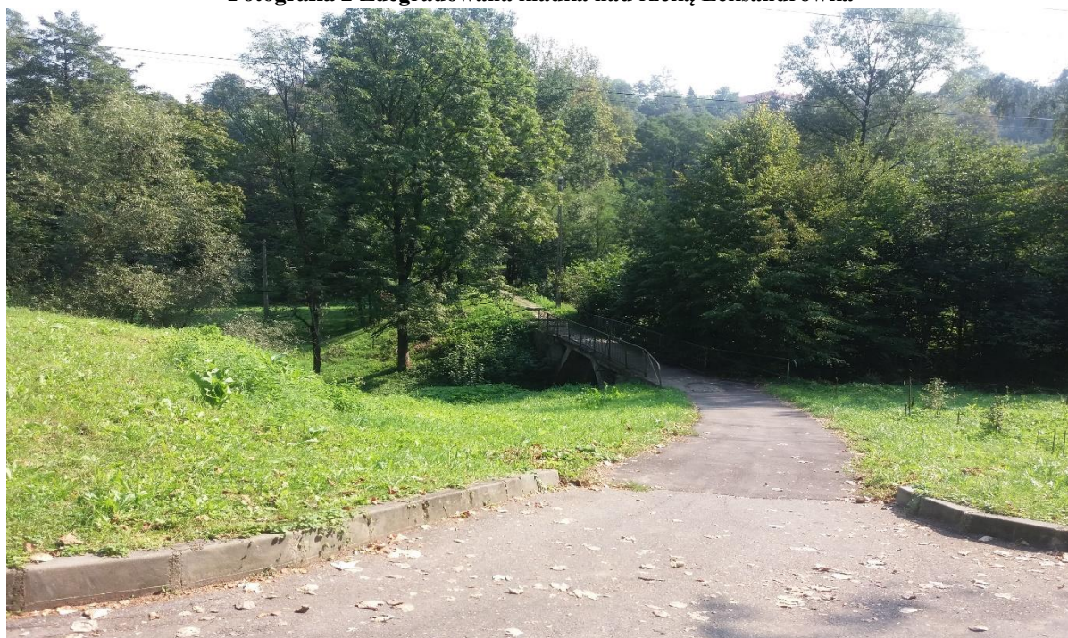
Fotografia 2 Zdegradowana kładka nad rzeką Leksandrówka
