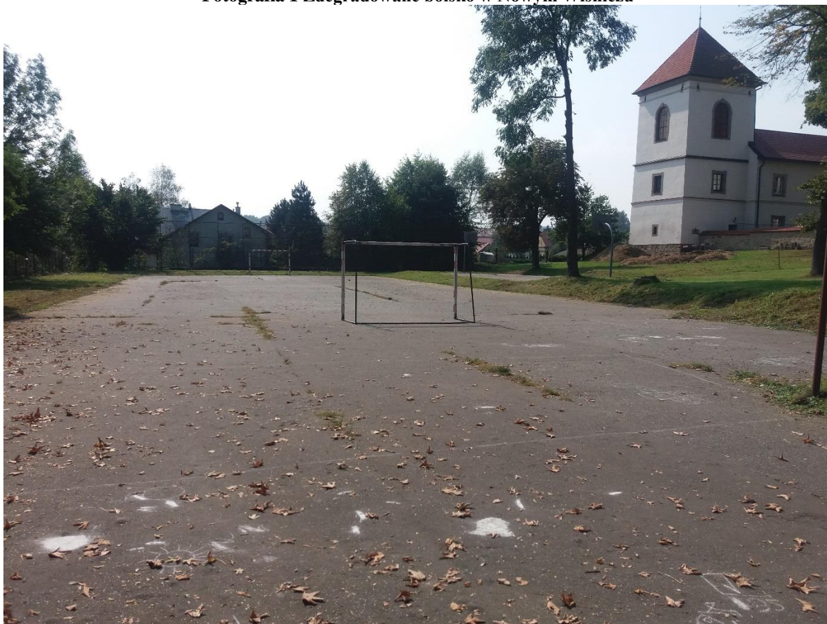
Fotografia 1 Zdegradowane boisko w Nowym Wiśniczu
