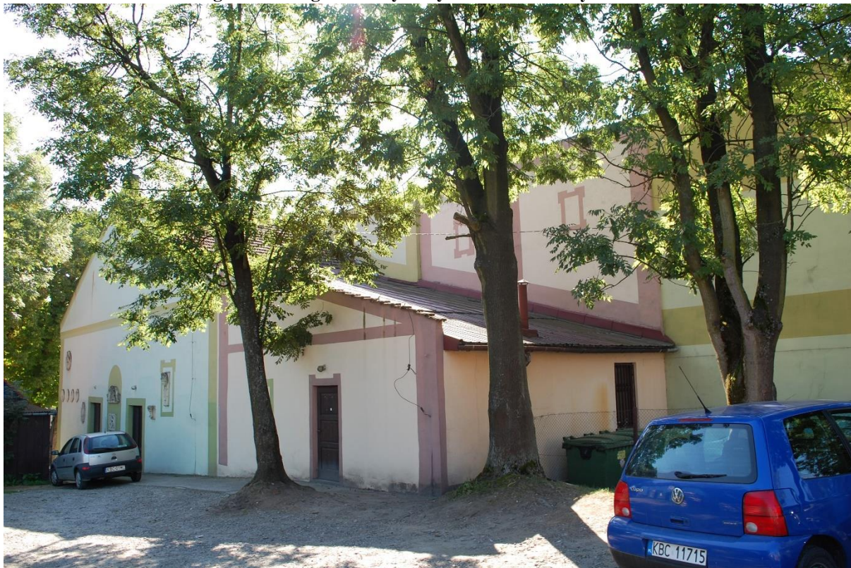
Fotografia 3 Zdegradowany budynek Kina w Nowym Wiśniczu
