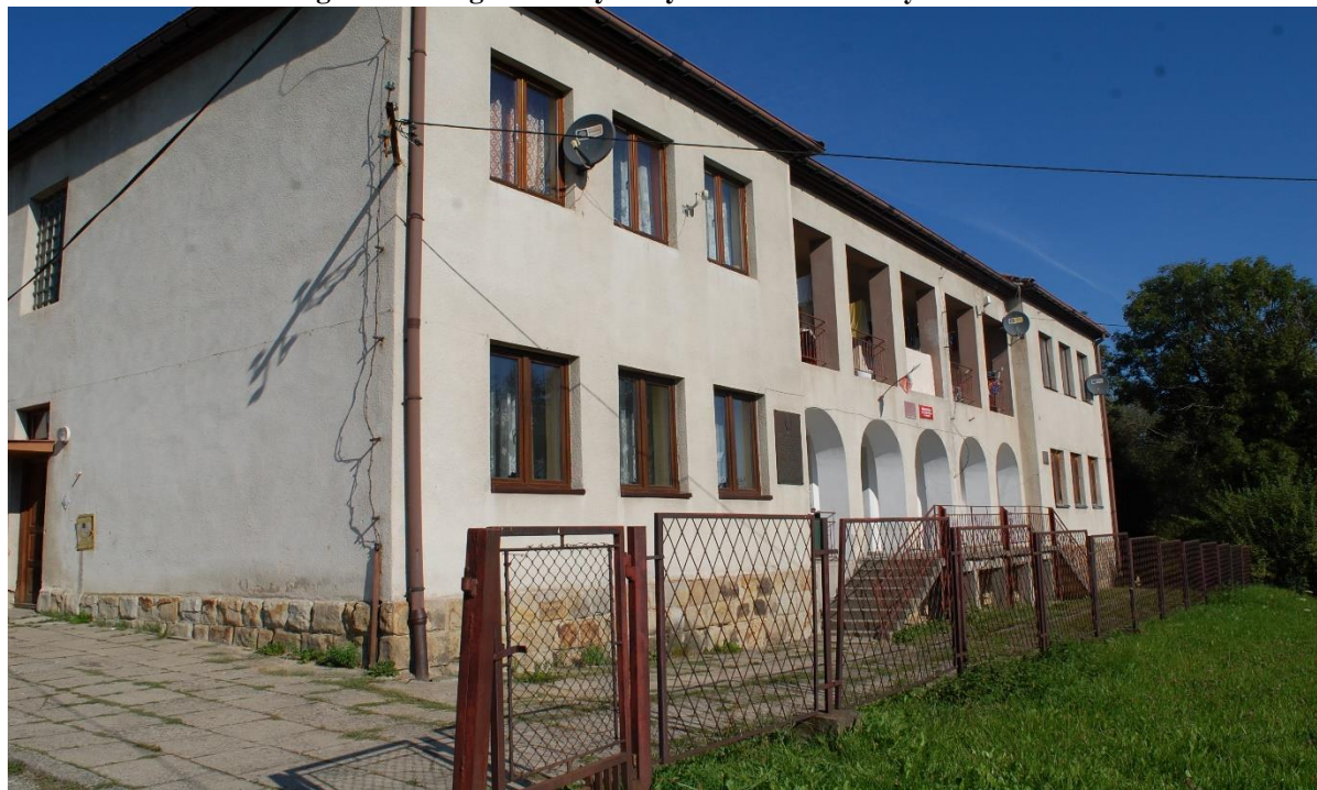
Fotografia 6 Zdegradowany budynek Domu Kultury w Królówce
