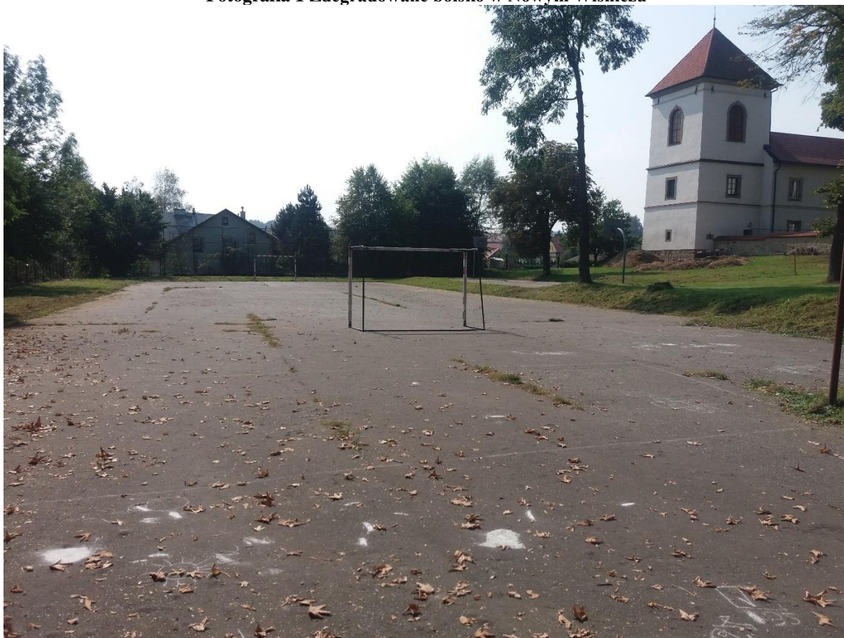
Fotografia 1 Zdegradowane boisko w Nowym Wiśniczu
